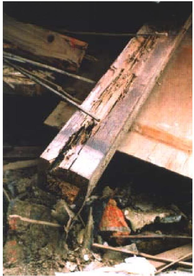
【阪神大震災で倒壊した家屋の柱の根元】
